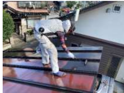
マツモト工務店の塗装職人☆ 毎日元気に頑張ってます。 お客様のお家を自分の家だと思って 隅々まで丁寧に塗装しています。 今日もこの街のどこかで一塗入魂!! 現場を全力で塗り替えています♪
